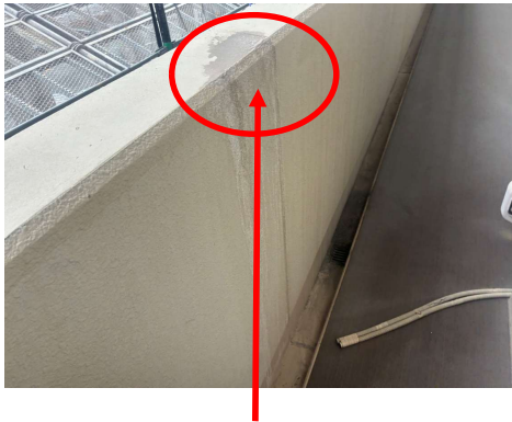
汚れや不陸等の劣化部
