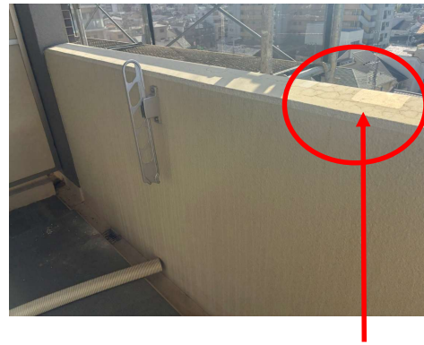
多数のひび割れ確認
