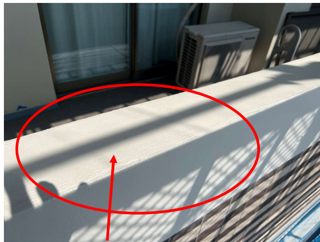
補修、塗装後も若干の補修跡確認
