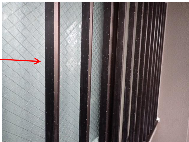
白斑と呼ばれる 錆の状況
